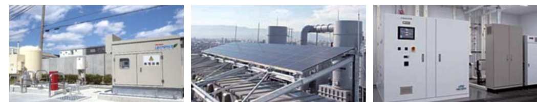
LPガス非常用発電機
